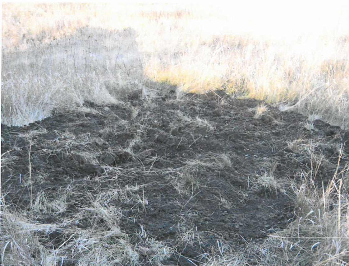
Рис. 11. Объект «Техническое перевооружение нефтесборного коллектора от АГЗУ № 1 Крюковского месторождения до ПНН «Крюковский». Рекультивированный рекогносцировочный шурф № 1. Вид с юго-запада.
