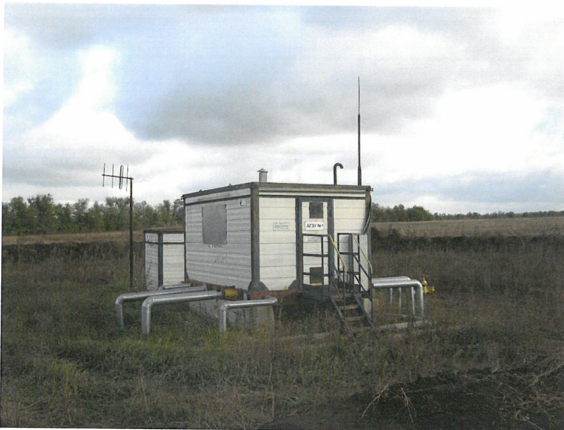
Рис. 3. Объект «Техническое перевооружение нефтесборного коллектора от АГЗУ № 1 Крюковского месторождения до ПНН «Крюковский». АГЗУ-1. Вид с северо-запада.
