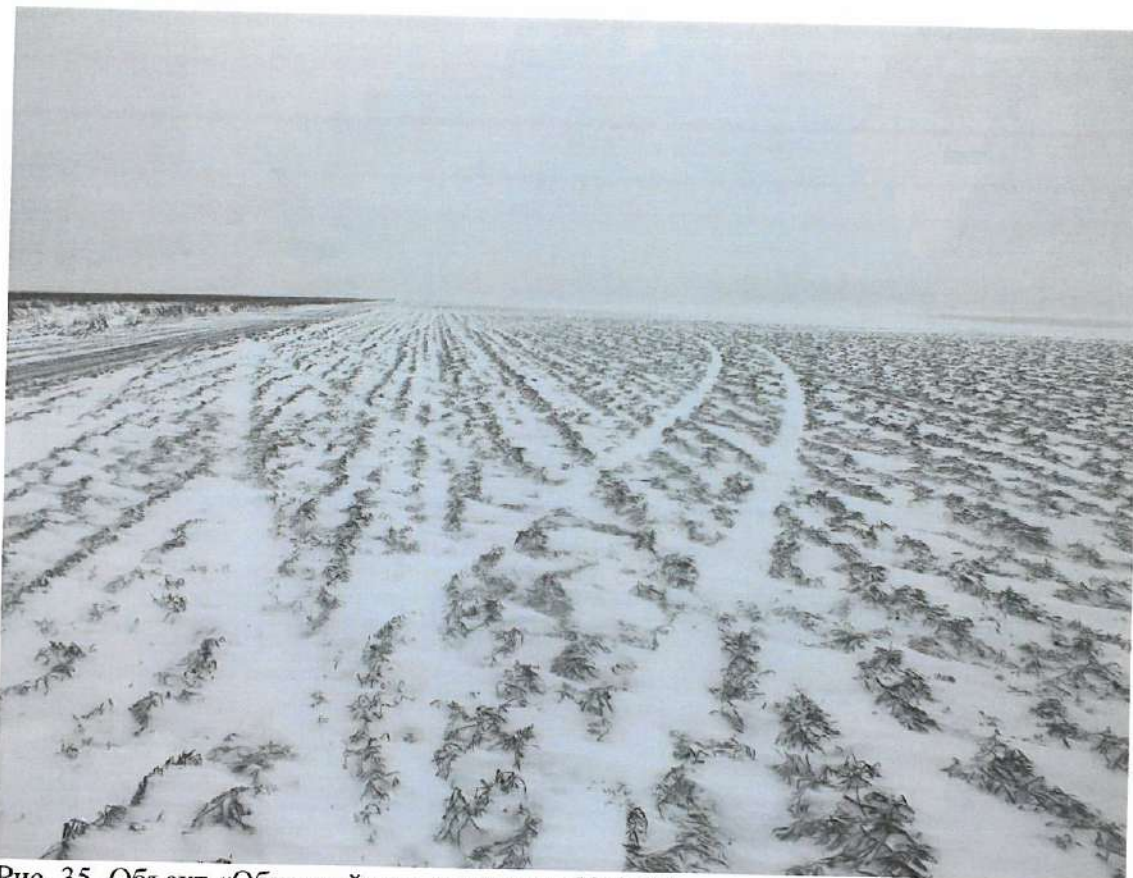
Рис. 35. Объект «Обустройство скважины № 25 Токолянского месторождения». Выкидной трубопровод и ВЛ. Вид с ВЮВ.
