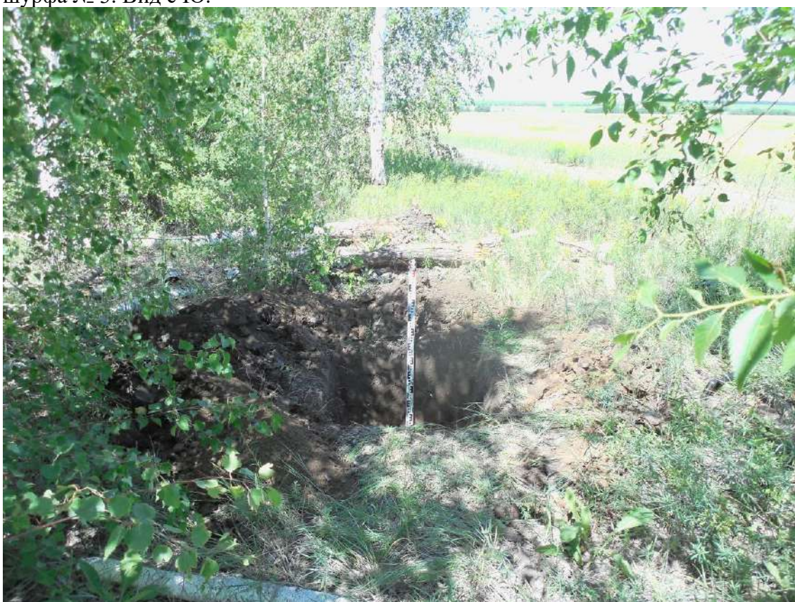
Рис. 33. Объект «Техническое перевооружение нефтегазосборного трубопровода от АГЗУ-5 Веселого месторождения до точки врезки ...». Рекогносцировочный шурф № 3. Вид с Ю.
