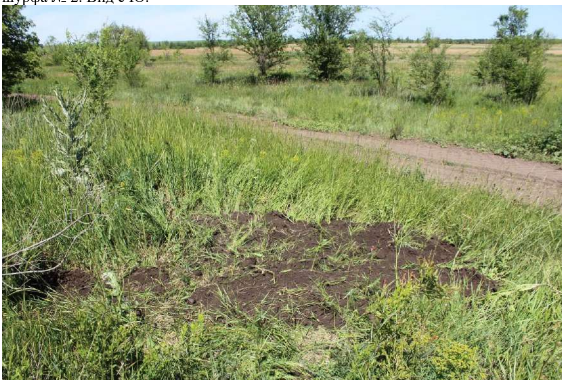
Рис. 31. Объект «Техническое перевооружение нефтегазосборного трубопровода от АГЗУ-5 Веселого месторождения до точки врезки ...». Рекультивация рекогносцировочного шурфа № 2. Вид с Ю.
